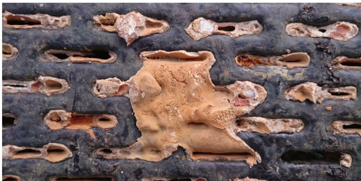
Bild 2: Ausgefüllte Karbonate in Filterrohrschlitzen nach nicht fachgerechter chemischer Regenerierung
