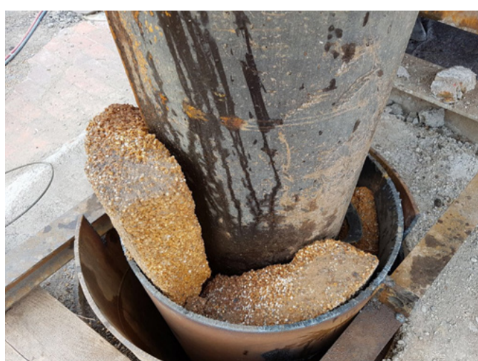
Bild 3: Durch chemische Regenerierung verhärtetes Kiesmaterial im Ringraum bei Bergung
